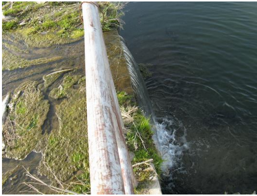
图1 泄洪洞西侧渗漏区水流排向消力池
