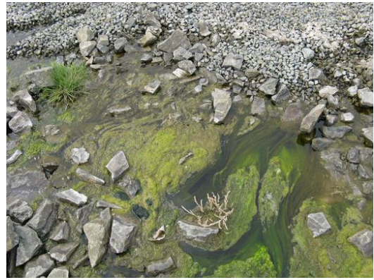
图2 桩号 0+495~0+515 段坝后坡脚集中式明流
