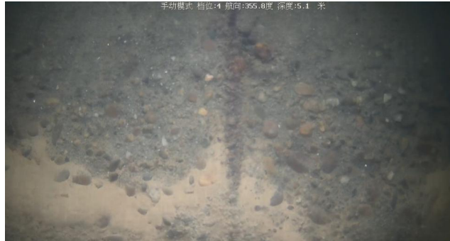
图 4 防渗面板露筋（高程 444.7m）
