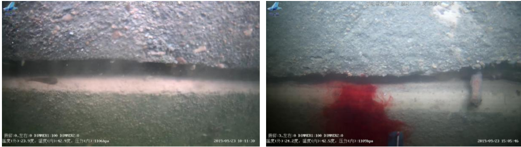
图 6 水平施工缝渗漏（高程 448.0m）
