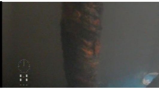
图 9 拦污栅栅条锈蚀
