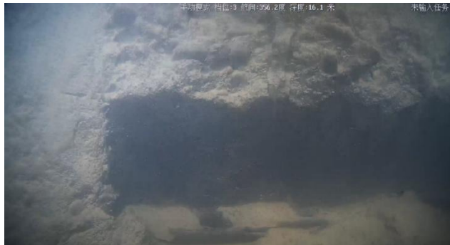
图 5 面板混凝土孔洞（高程 432.0m）
