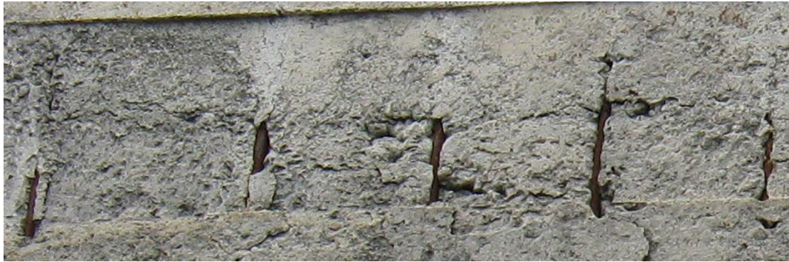
图5 砼防渗面板分缝裂开，钢筋外露锈蚀
