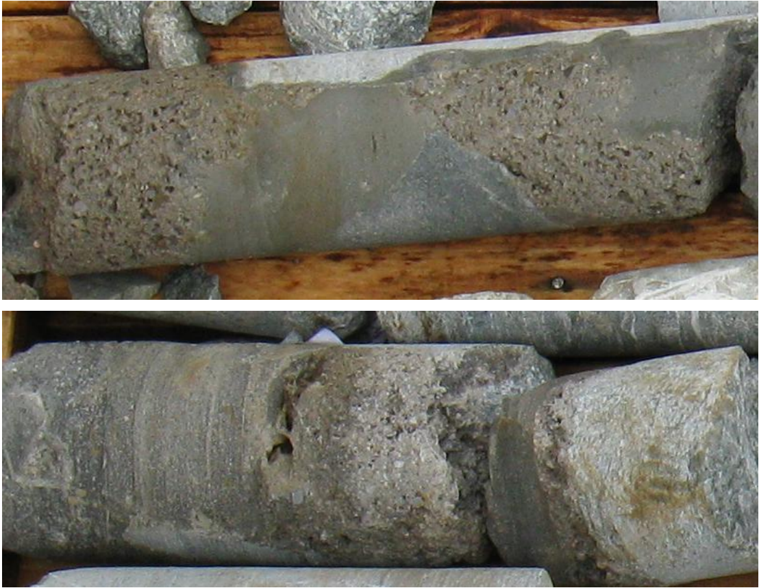
图4 钻孔揭示砂浆中存在空洞，岩芯呈蜂窝状
