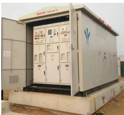
图 5 华柴暗渠箱变现场设备照片
