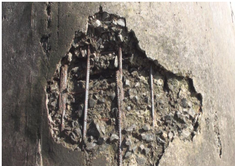
图1 尾水闸墩水位变化区混凝土表面剥蚀、钢筋外露
