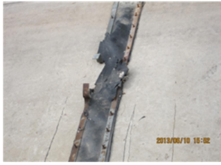
图1 锚固型卷材止水典型破坏
