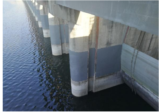
图9 潘家口下库混凝土坝冻融剥蚀处理后情况
