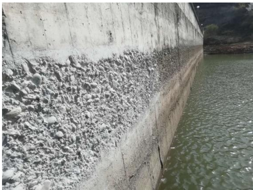
图10 海甸峡混凝土坝冻融剥蚀情况
