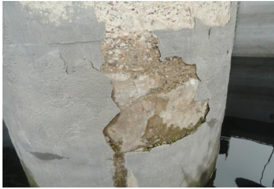
图8 潘家口下库混凝土坝冻融剥蚀情况
